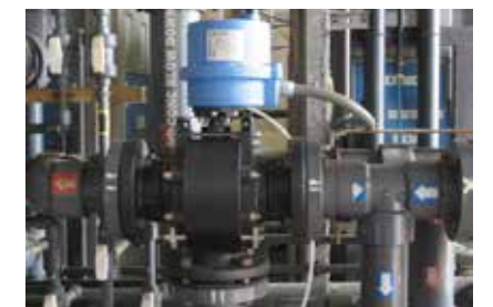
Water demineralisation unit
